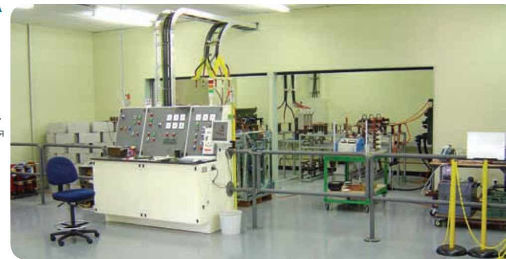
Лаборатория высоковольтных испытаний AuCom
